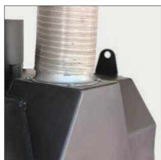
Entrada de aire exterior.
