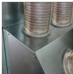
Posibilidad de conducción del aire caliente.
